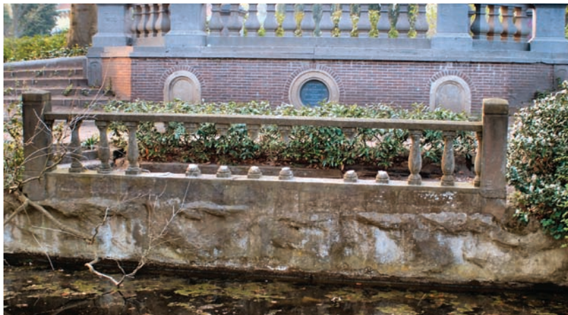
Schade aan de colonnade
